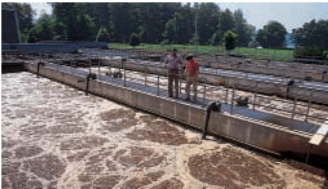
Abb. 2: Nährstoffreicher Urin belastet die Kläranlagen.
